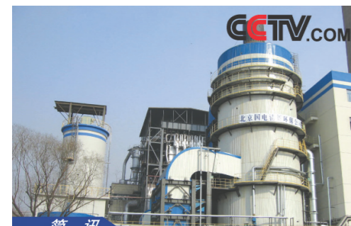
国内首套独立知识产权的湿法脱硫装置： 陡河发电厂 #8 机组脱硫装置建造项目
