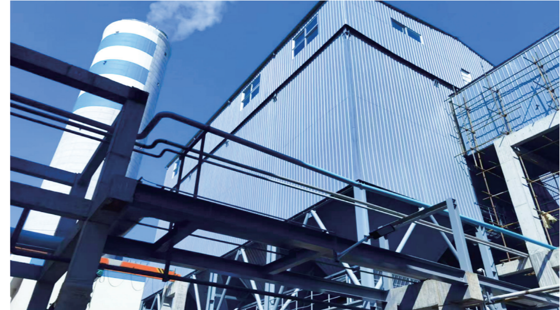
浙江盛元集中供热项目配套袋式除尘器
